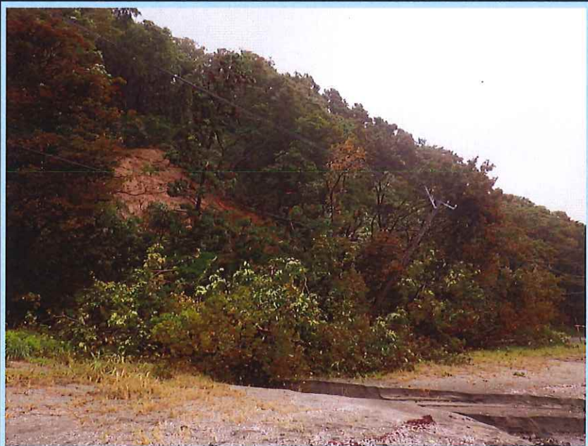
被災状況 (平成30年8月)
